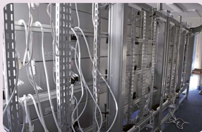
Cablage et structure support des écrans, permettant différentes configurations
